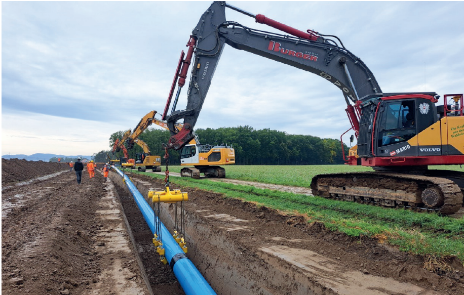
Bild 2: Verlegung der Transportwasserleitung DN 500 im Zuge der EVN-Verbindungsleitung Krems-Zwettl (Quelle: Dipl.-Ing. Schneider)
