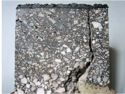
Bild 4: Bohrkernausschnitt eines Risses mit Tiefenwirkung, überbaut mit Asphaltvlies und EO.
