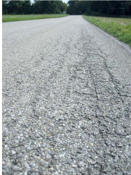
Bild 1: Zustandsbild einer Gemeindestraße mit Netzrissen
