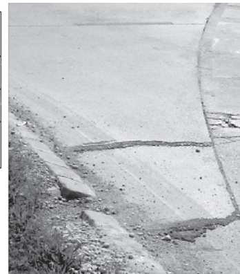
Abb. 2 (rechts): Schadensfall im Übergangsbereich
