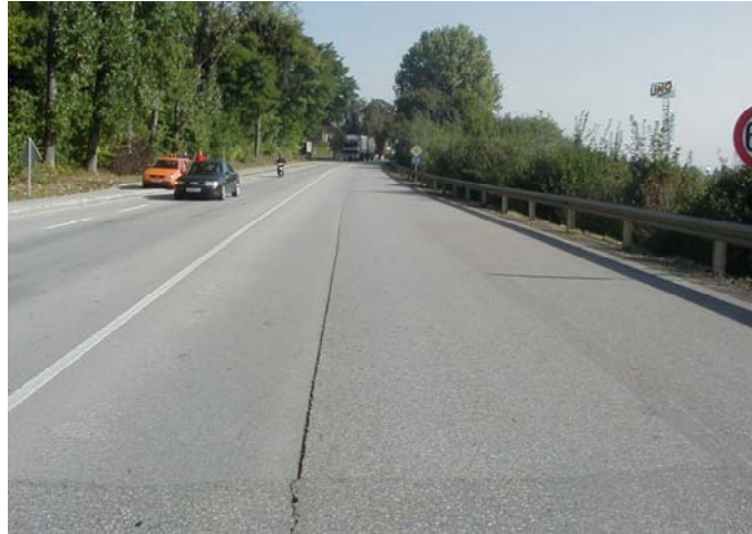
charakteristisches Schadensbild (offene Mittelnaht)
