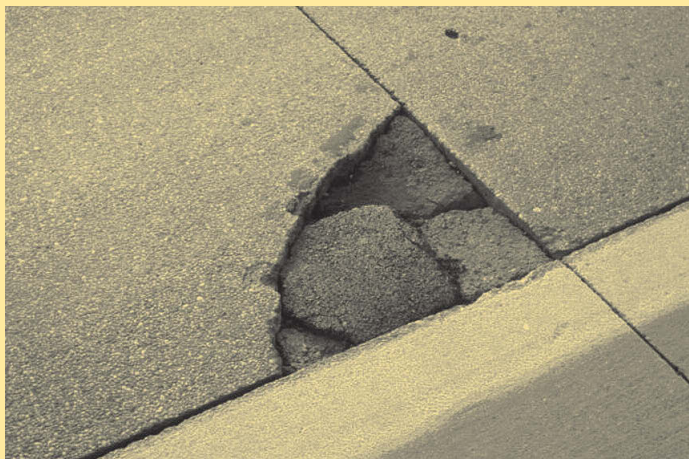
Abbildung 6: Eckabbruch Betondecke (Foto Sommer)
