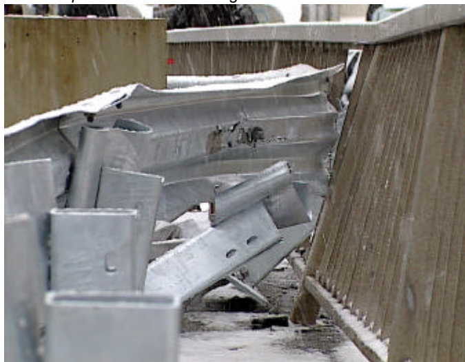
Deformation der Stahlleitschiene durch den Anprall
