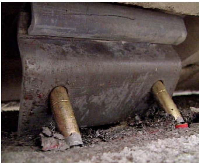
An einigen Stellen wurden Scherlastanker bei der Betonleitwand ausgezogen
