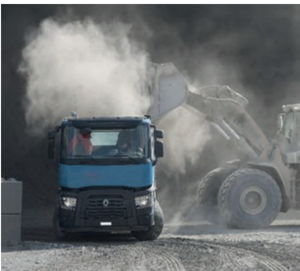
Bild 1: Staubentwicklung auf einer Baustelle
