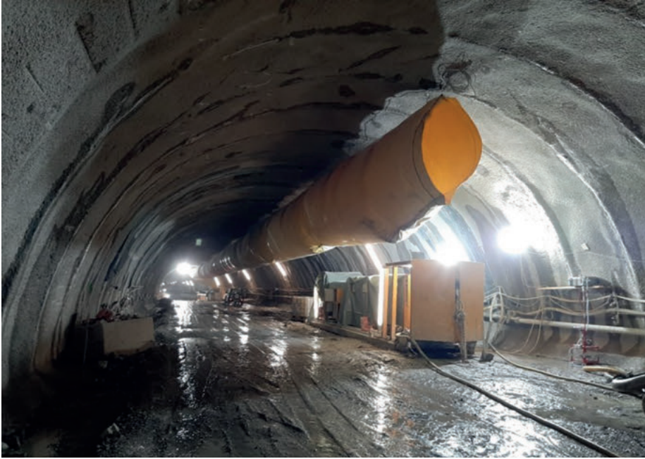
Bild 2: Luttenauslass im Bereich der Ortsbrust zur drückenden Bewetterung
