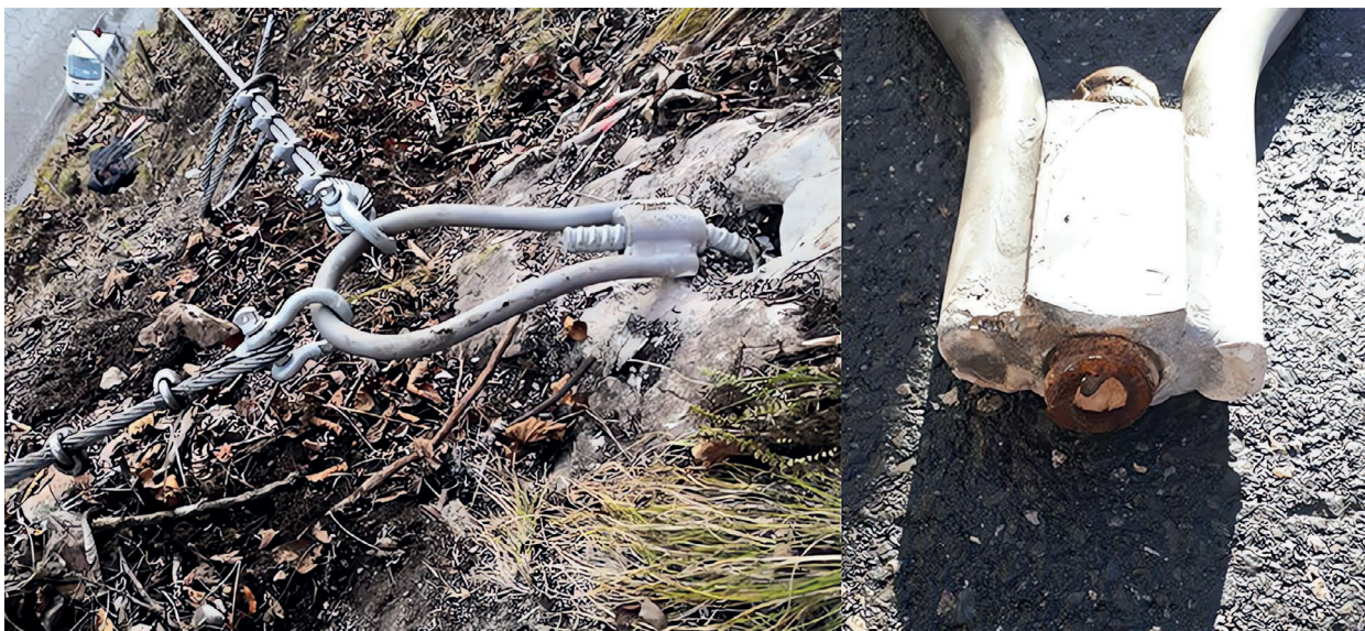
Bild 4: Beispiele von mangelhaftem Steinschlagschutz: links schadhafter Pfahlkopfan schluss, rechts gebrochenes Tragglied, führt zu hohen Instandhaltungskosten
