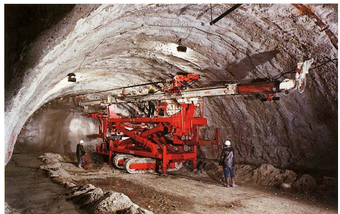
Abb. 1: Anwendung des Düsenstrahlverfahrens für die Herstellung eines Schirms zur Stützung des Vortriebs (Quelle: www.rodio.ch)
