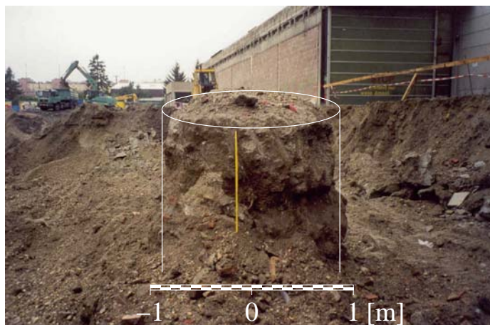
Abb. 2: Freigelegte Testsäule für die Validierung des entwickelten Rechenmodells zur Bestimmung des Zementanteils im Bodenmörtel und der Abmessung der DSV-Säule
