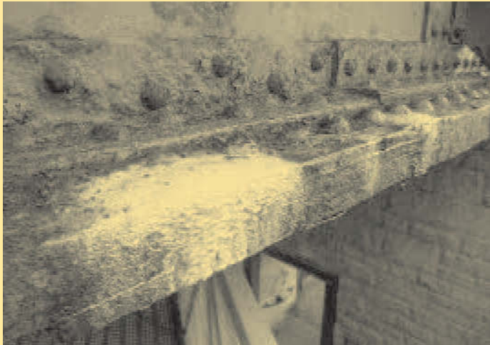
Abb. 1: Brücken-Korrosion. Foto: DI. Dr. Kurt Kratzer
