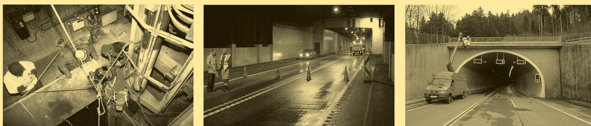
Abb. 2: Die RVS 13.03.31 erfasst alle Bereiche der Tunnelanlage, so insbesondere Tunnelstrecke, Lüftungsschächte und -stollen, Portale und Einfahrtsbauwerke
