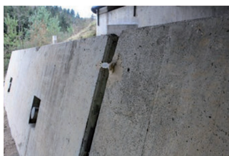
Bild 3: Schaden durch Bauwerksversatz
