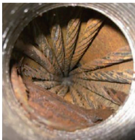
Bild 5: Korrosion im Ankerkopfbereich
