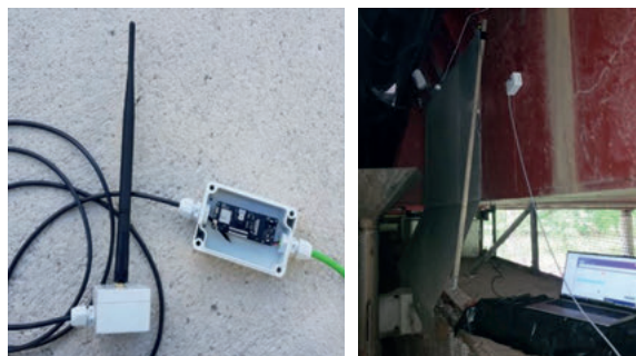
Bild 3: 4. Prototyp des Monitoring-Systems (links); Installation im Hohlkasten der Brücke (rechts)
