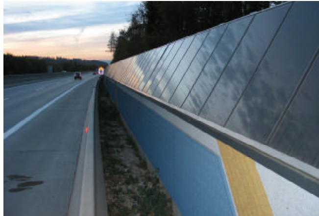
neue Lärmschutzwand mit integrierten photovoltaischen Elementen
