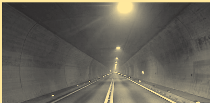
Abbildung 5: 90er Jahre – Beleuchtung Roppener Tunnel
