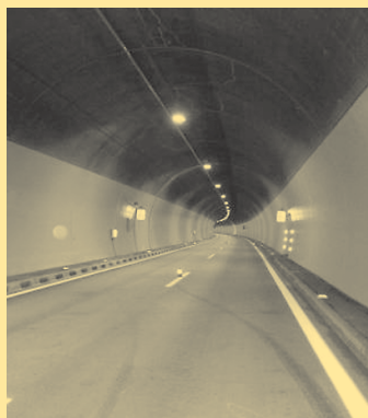
Abbildung 6: 2009 – Beleuchtung Milser Tunnel
