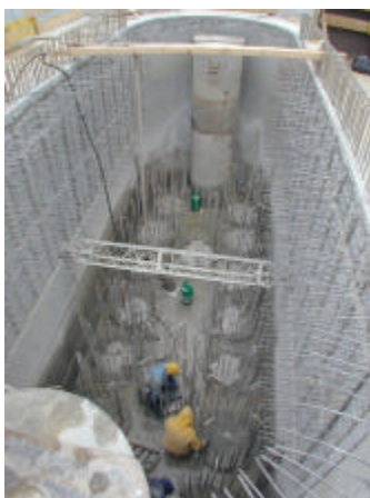
Herstellung eines Fundierungskastens aus Bohrpfählen (vom Schiff aus) für eine Flussbrücke; erkennbar sind Sekundärpfähle mit Bewehrung
