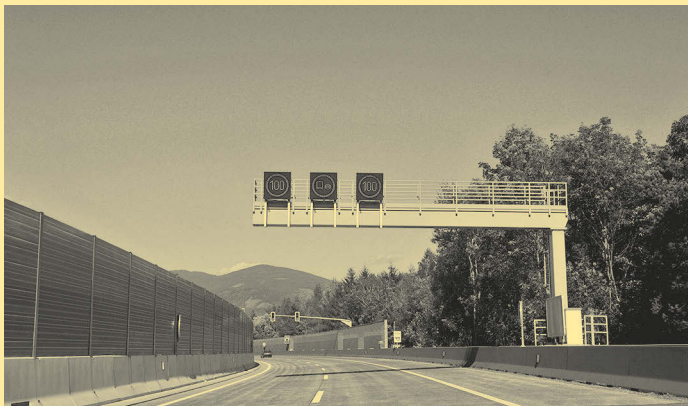
Bild 5: Verkehrsbeeinflussungsanlage A 10 (Quelle: ASFINAG)
