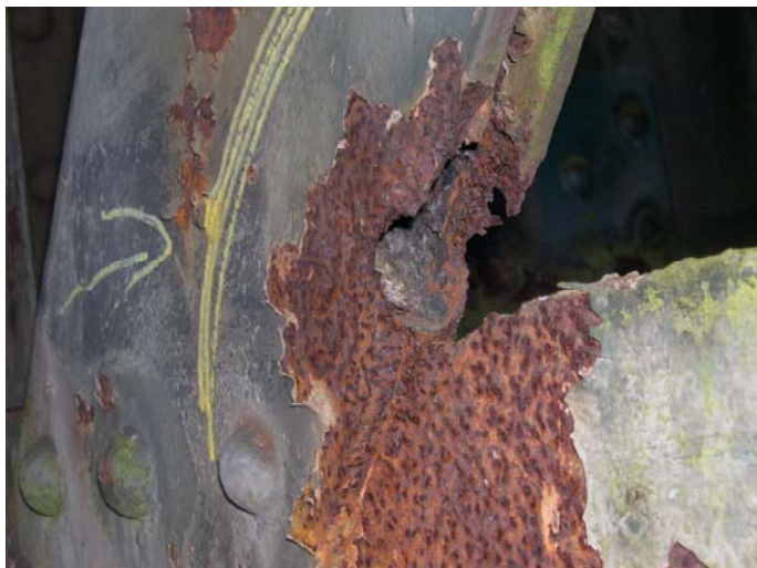
stark korrodiertes Knotenblech
