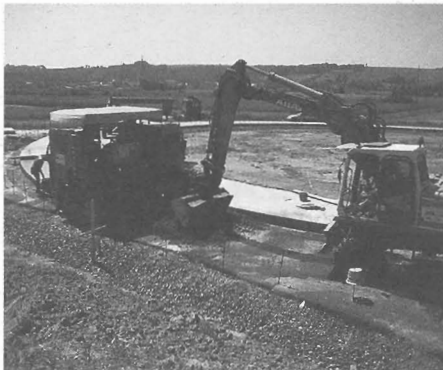
Infrastrukturbau: Schwere Baumaschinen sind bei der Errichtung von Straßen und Verkehrswegen heute unentbehrliche Helfer.
